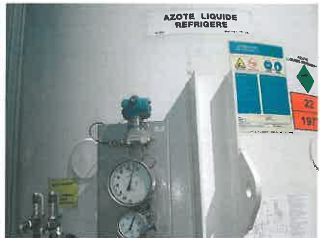
Dispositif de mesure de la pression en continu (bleu) en vue de rechercher les causes de la fuite d'azote sur la cuve de stockage
