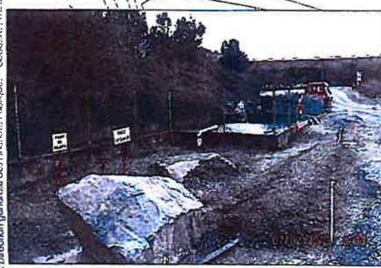
Bassin d'eau claire et vanne de fermeture du rejet
